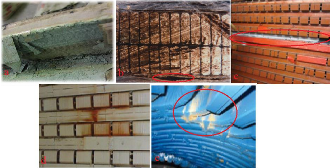
2.1. att. Izplatītākie ģeneratora statora defekti [13], [15].
