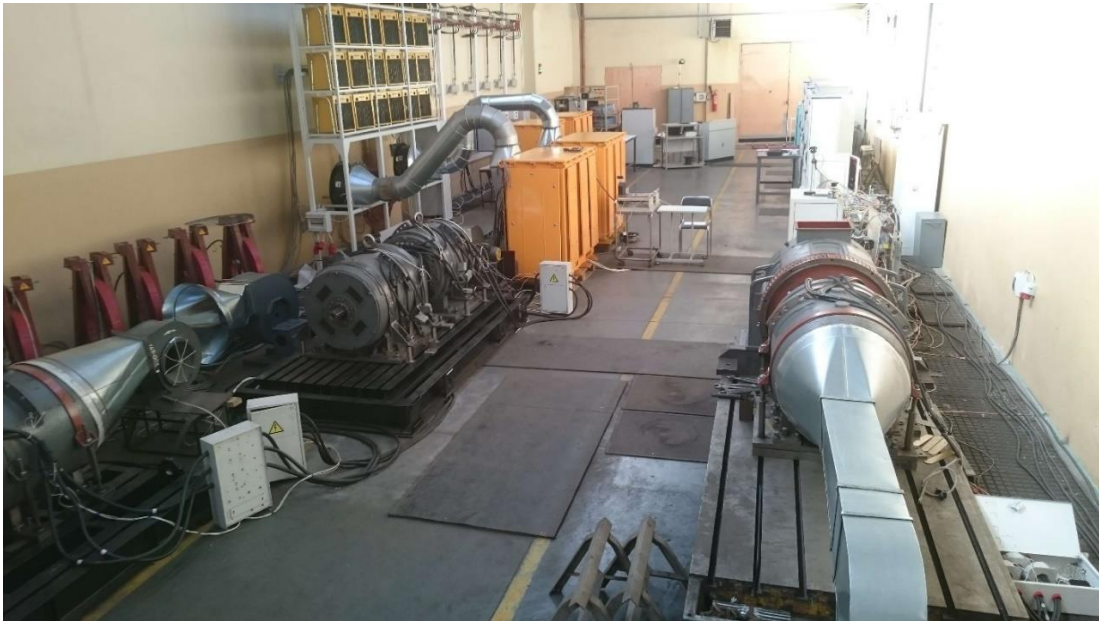
3.4. att. AS “Rīgas elektromašīnbūves rūpnīca” agregātu laboratorija. Laboratorijas kopskats.
