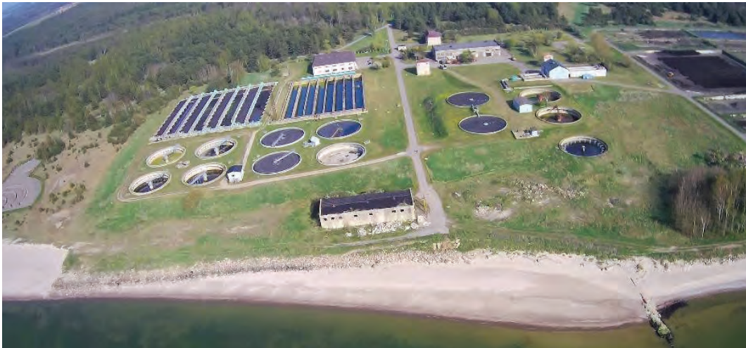
7. attēls. Notekūdeņu attīrīšanas iekārtas Liepājā ar projektēto jaudu 55 000 m 3 /dnn, SIA „Liepājas ūdens” arhīvs
