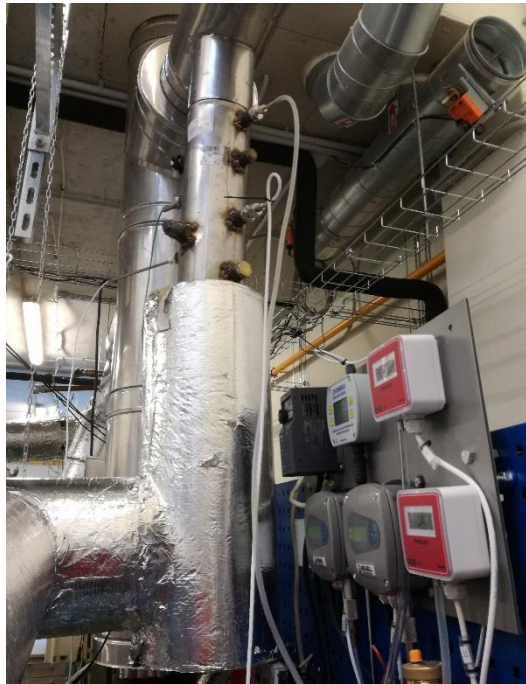
2.4. att. Dūmvads un mēriekārtu pieslēgumi pēc MA.
