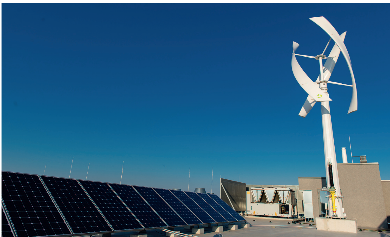
Vertikālās konstrukcijas vēja ģenerators uz EVIF mājas jumta Āzenes ielā 12/1. Wind generator of vertical construction on the roof of FEEE at Āzenes iela 12/1.
