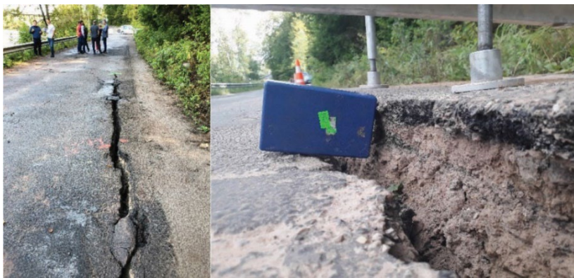
3.2. att. Peldu ielas ceļa konstrukcijas deformācijas.
