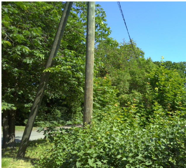
4.14.att. Veģetācijas defekta piemērs elektrotīkla aizsargjoslā.
