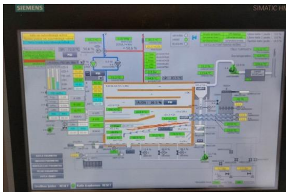
2.43. attēls. Vadības paneļa ekrāns (Siemens SIMATIC HMI)
